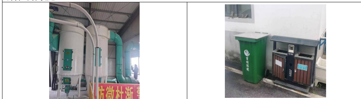
干粉车间脉冲除尘器
