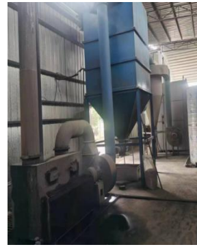
3t/h 蒸汽发生器旋风+脉冲除尘+水膜除尘
